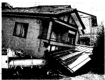
熊本地震で倒壊した木造住宅(益城町)
